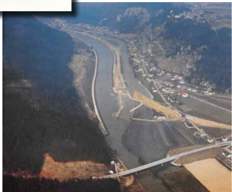
Altmühl bei Essing. Links das fertiggestellte neue Flußbett der Altmühl, rechts der bisherige Flußlauf, der als Altessing verbleibt. Dazwischen wird die neue Umgehungsstraße gestiftet.
