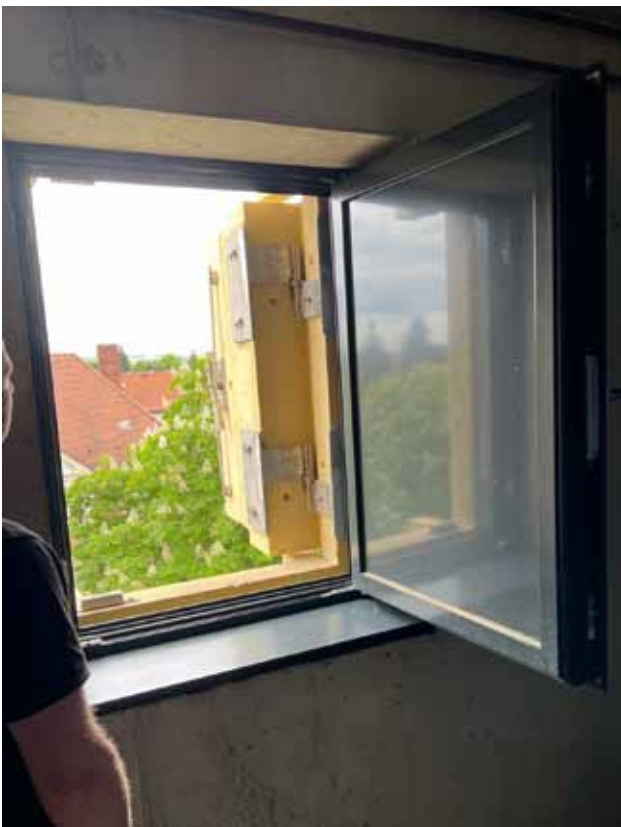
Fluchtfenster im Erweiterungsbau des Staatsarchivs Bamberg; Foto: Generaldirektion der Staatlichen Archive Bayerns.
